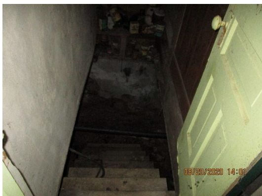
Planche 36 : Escalier du sous-sol, considéré dangereux pour l'accès
