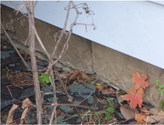
Planche 28 : Détail des interstices dans la fondation
