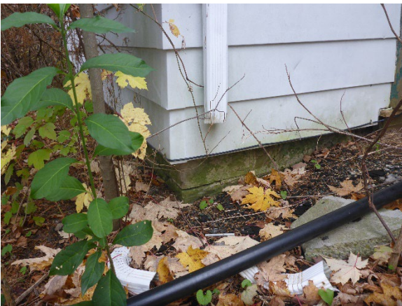
Planche 30 : Descente de gouttière qui s'écoule sur la fondation
