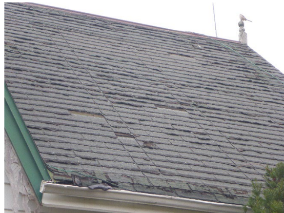
Planche 31 : Toit en mauvais état
