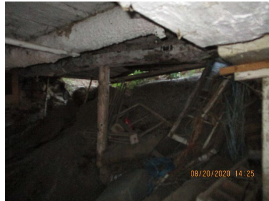
Planche 39 : Mur de fondation effondré
