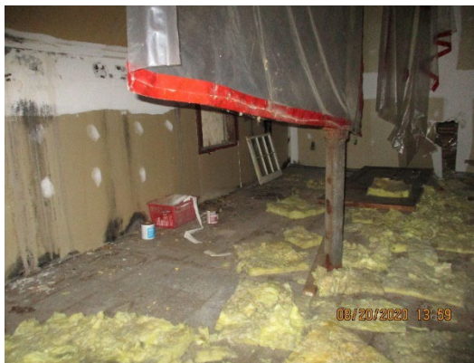
Planche 33 : Gypse endommagé par l'eau et moisissure noire
