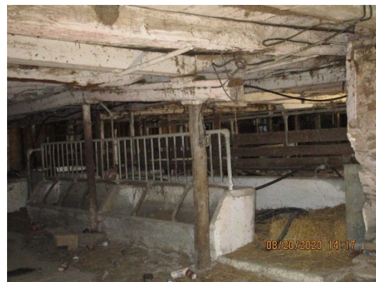
Planche 41 : Poutre porteuse intérieure dont l'intégrité est douteuse
