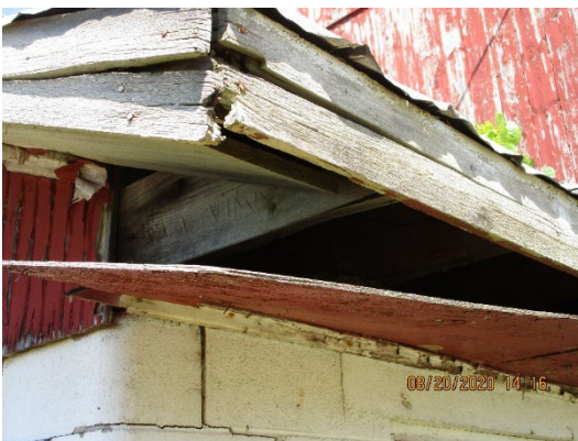
Planche 40 : Effondrement des poutres porteuses extérieures
