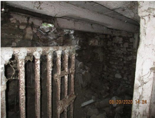
Planche 38 : Interstice dans la fondation
