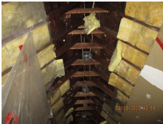
Planche 35 : Dégâts d'eau causés par les fuites du toit
