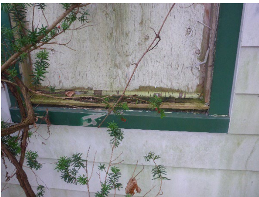
Planche 6 : Garniture métallique sur la fenêtre, qui apparaît également sur les portes et le toit, façade ouest, vue vers l'est
