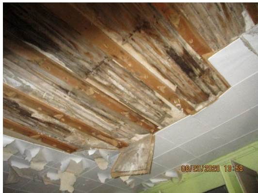
Planche 34 : Tuiles de plafond endommagées par l'eau
