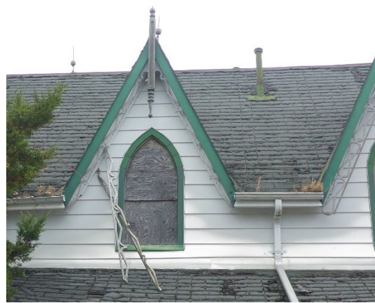
Planche 29 : Peinture usée et rive en pignon endommagée
