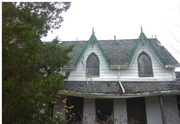
Planche 32 : Porche affaissé à l'est
